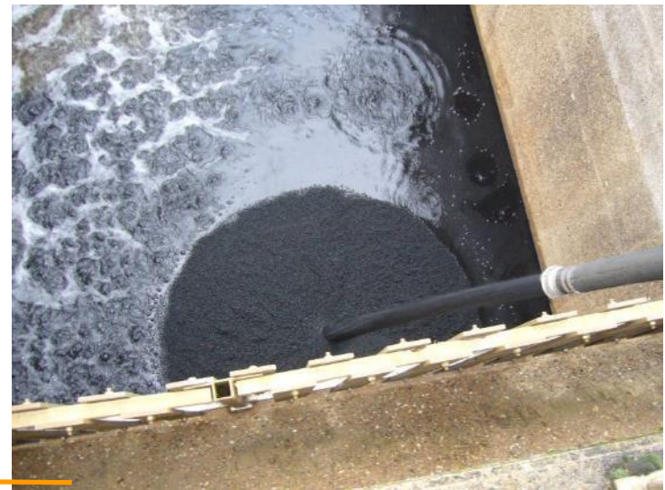
Treibwasserentnahme (Storz C)
