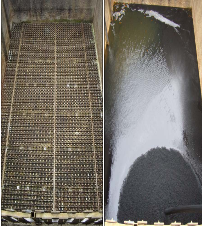
Leere Filterkammer vor der Befüllung (links) und während der Befüllung mit Aktivkohle (rechts)
